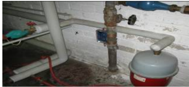
Trinkwasser-Installation in einem Wohngebäude Foto: GA MOL
